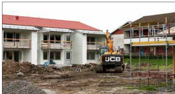
Grävmaskinen har påbörjat arbetet på innergården, som kommer att bli fylld med blommor, en damm, gräsytor, grusgångar och uteplatser.
